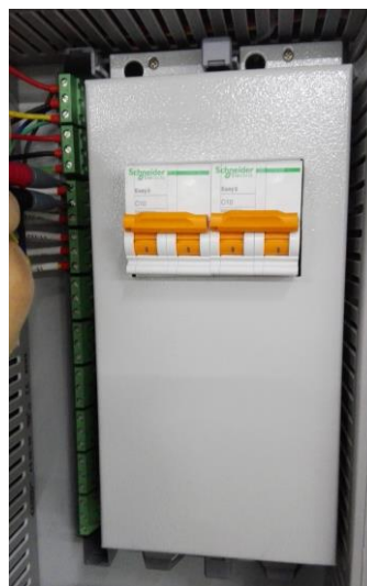
图8.4-2 UPS部分测试图
